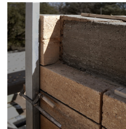
Ref.09 Forjado de vigas de madera con zuncho perimetral de hormigón armado, aparte de unir sirve para repartir el peso de las vigas encima de la pared estructural.
