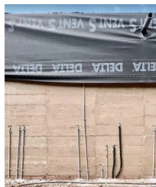
Ref.03 Instalaciones por la cara exterior del muro antes de colocar el corcho de aislamiento Installations on the exterior face of the wall before placing the insulation cork
