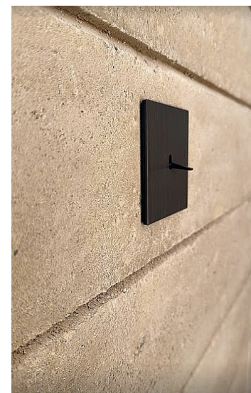
Ref. 01 Detalle de los interruptores Switches detail
